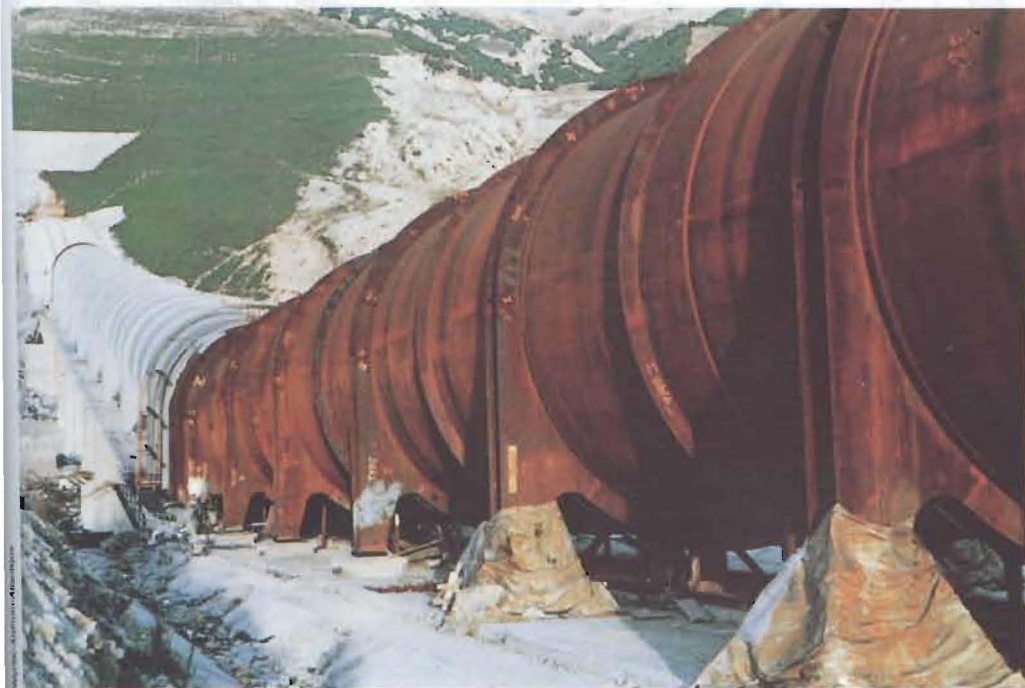
conducciones zunchadas para alimentar las turbinas de una central griega
